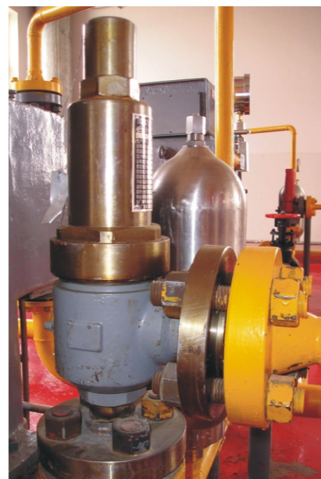
罗阀在中原油田甲醇加注泵房现场
