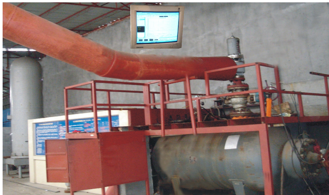
安全阀全性能试验装置
