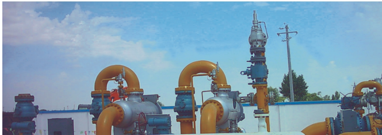
罗阀在塔里木油田现场运行
